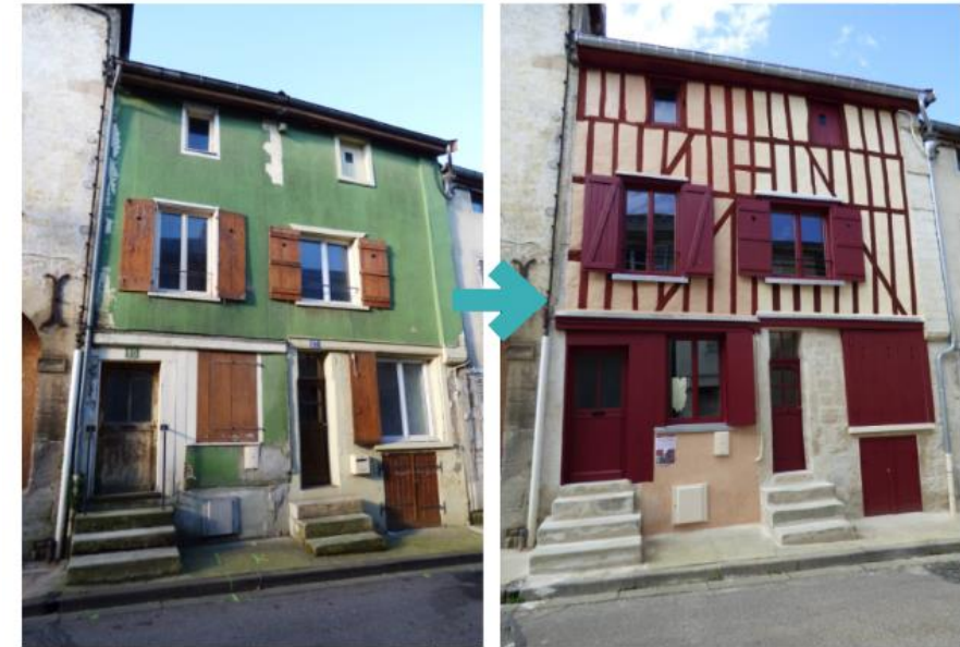
15 rue des Royaux avant et après travaux : mise en valeur d'un pan bois via un chantier de bénévoles © Joinville
